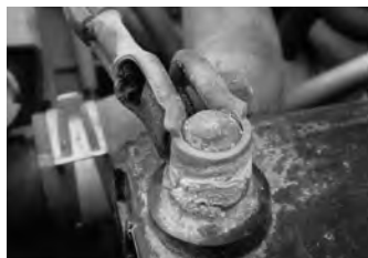
腐食したターミナル
