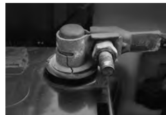
亀裂が入ったターミナル
